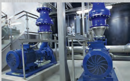
Станция водоснабжения в г. Вертхайм, Германия
